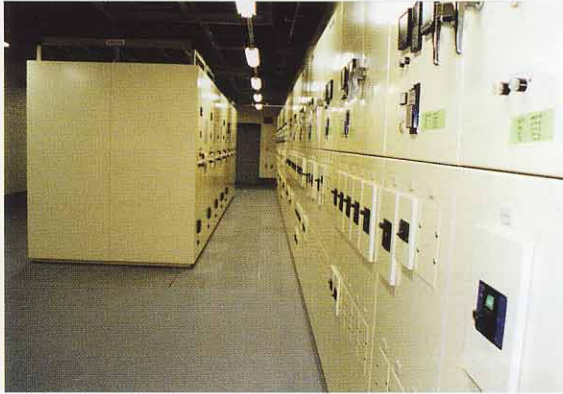
新病棟電気設備
