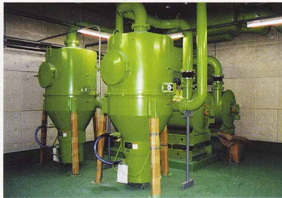
新病棟集塵設備
