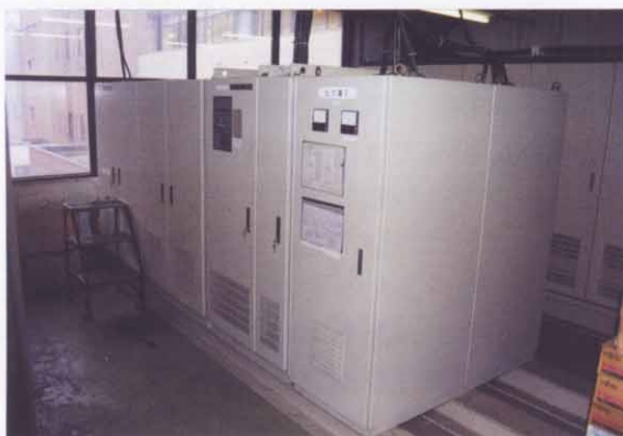
写真7 電源バックアップ装置 30分の停電にたえられる
