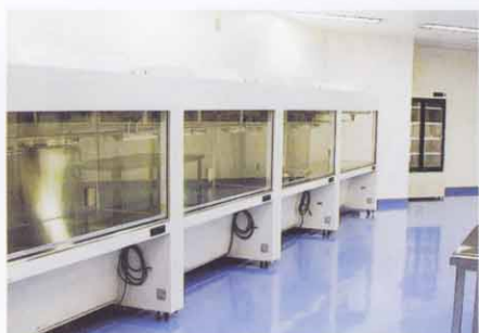
IVH・注射薬調整室 (約80m 2 ) 地下1階に位置し、IVH・注射薬の調整用のクリーンベンチが4台設置されている
