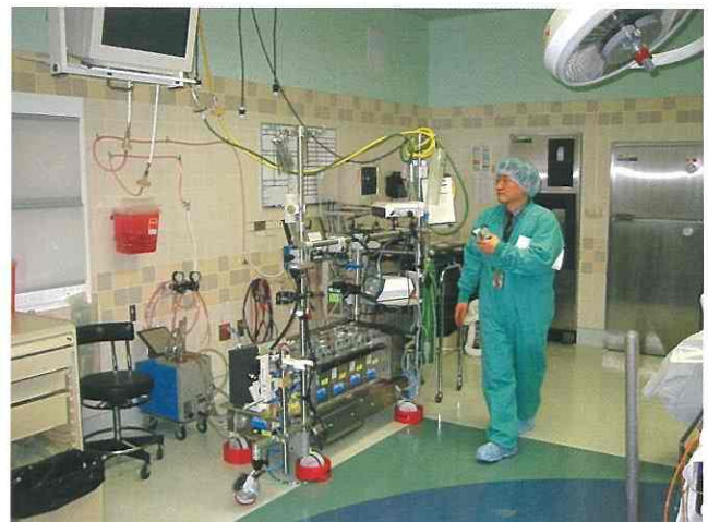
スウェディッシュメディカルセンター（シアトル）手術室内でシーリングペンダントをチェックする関山先生
