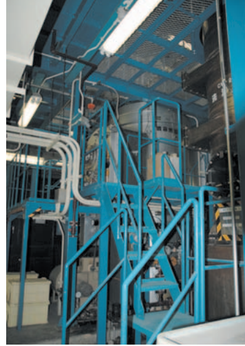
センターの焼却炉
