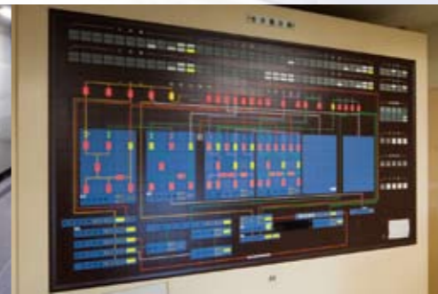
エネルギーセンターの中央監視室
