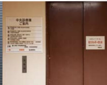
停止した職員用エレベーター
