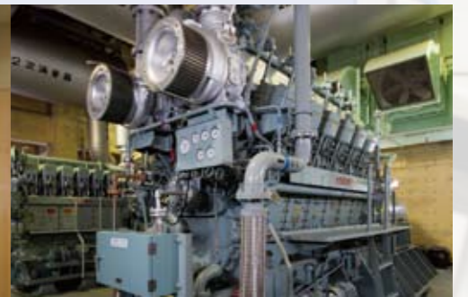
非常用自家発電装置
