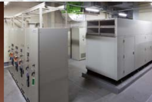
非常用自家発電装置
